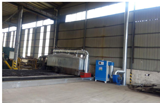
等离子切割南及烟尘净化器+排气筒 P3
