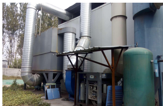
喷砂工序环保设备及排气筒 P2
