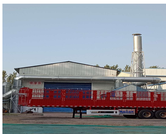
喷漆房及排气筒 P1
