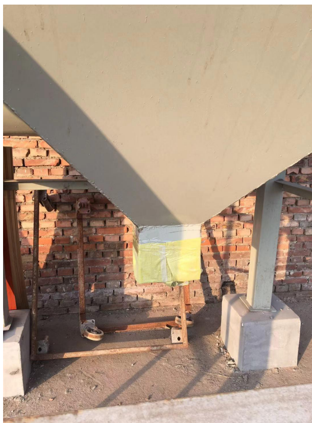
除尘器出口照片
